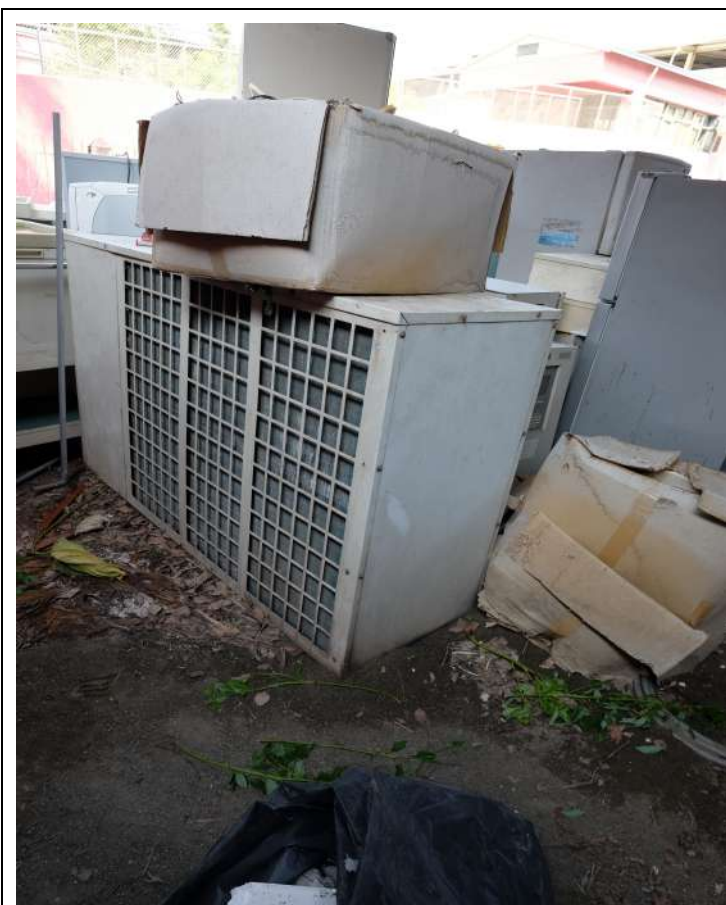
空調主機（廢品區）
