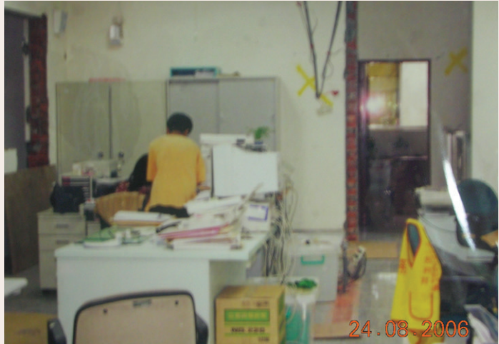
本處新建大樓1樓921地震受損情形。
