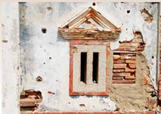
北山古洋樓牆垣部分彈孔，處處清晰可見。 資料來源：金門國家公園管理處
