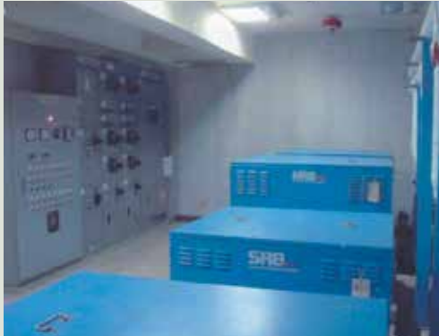
污水處理廠主機房。
