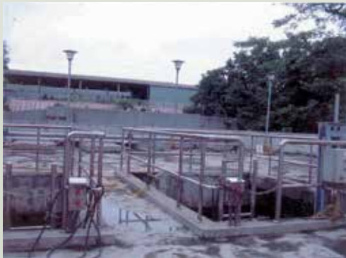
污水處理廠排放分流管線。
