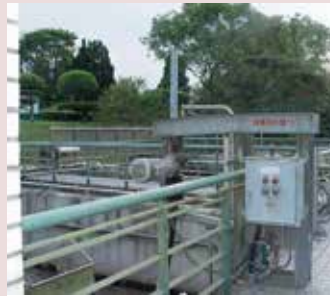
污水處理曝氣池。
