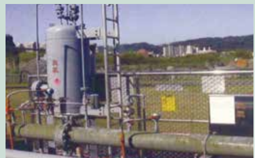
天然氣嗅劑自動添加設備。
