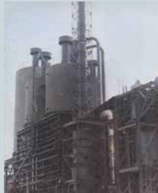
中磷公司儲油庫。
