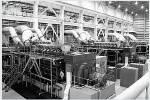
澎湖尖山發電廠1至4號發電機。
