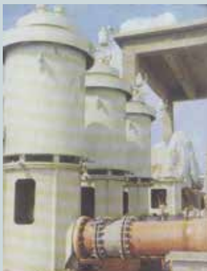
中鋼水處理設備。
