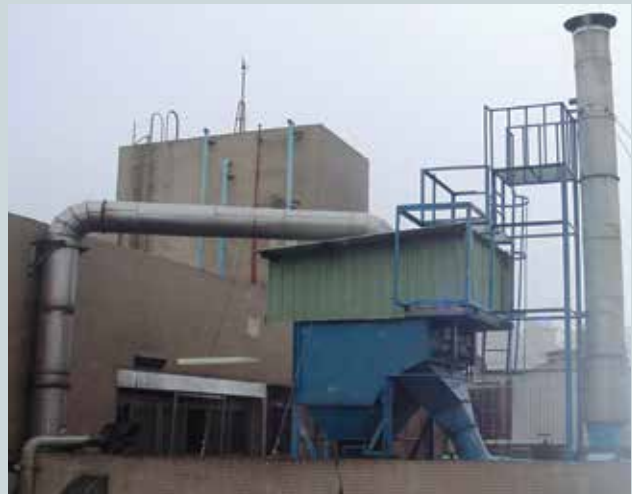
粉塵處理設備。
