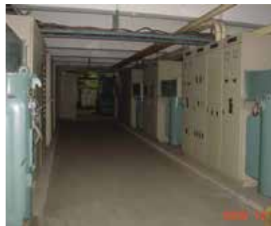
地下室電力設備。
