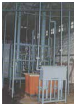
乙炔純化設備。
