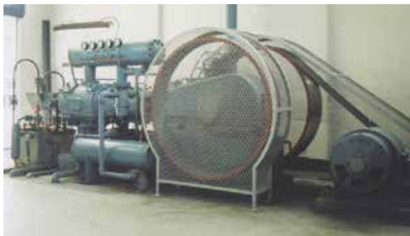
製造氧氣之空氣壓縮機。
