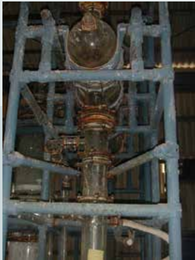
酸場生產線冷凝器。
