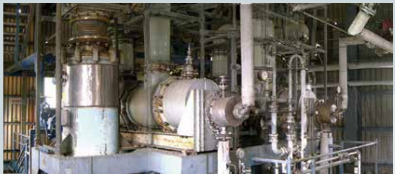
酸場生產線製酸設備。
