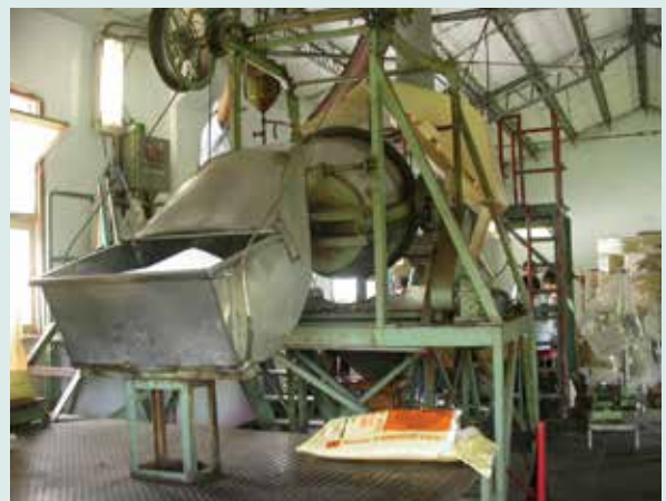
硝油炸藥生產設備。
