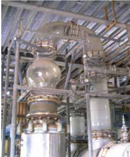
硝酸提濃設備。
