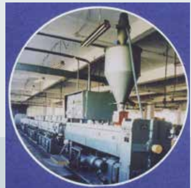
生產PE管之機器。
