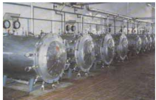
罐頭高溫殺菌設備。
