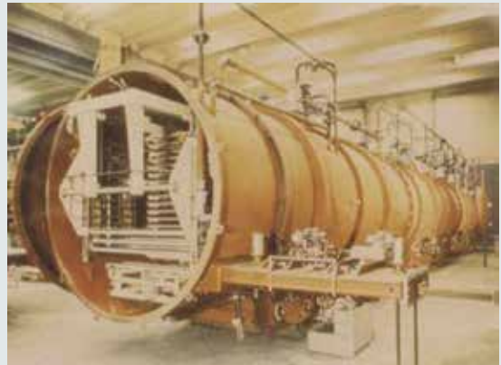
冷凍乾燥設備。
