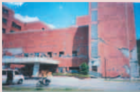
921大地震醫療大樓外觀損毀情形
