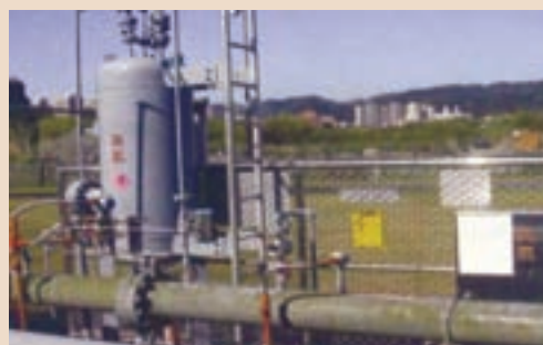
天然氣嗅劑自動添加設備。
