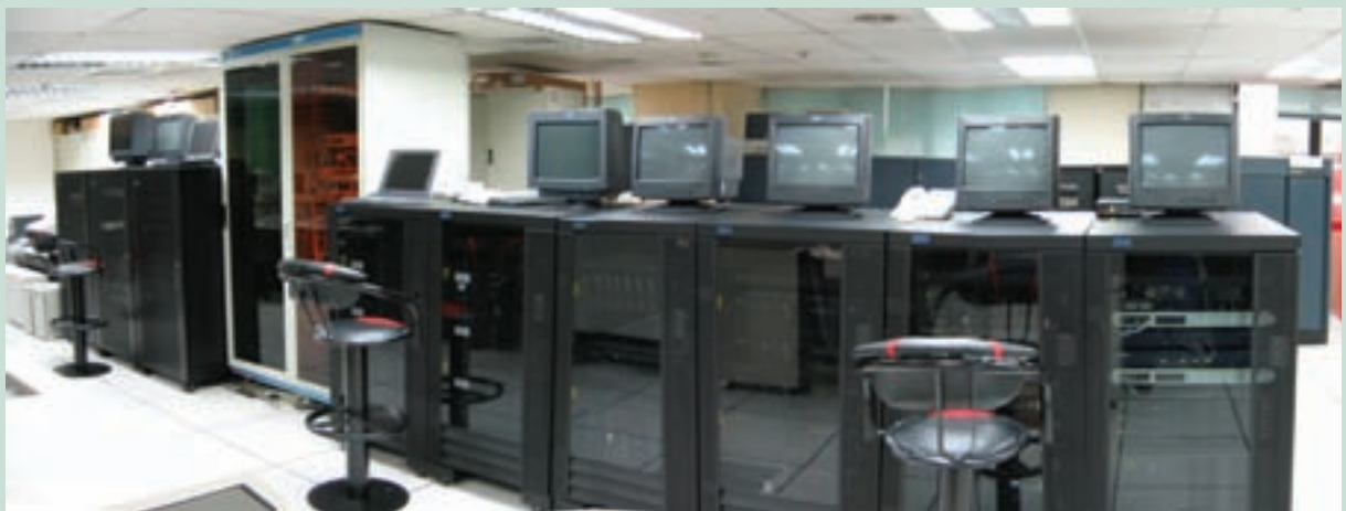
本會自民國84年由專屬大型主機換裝為開放性電腦系統，機房已看不到龐大主機，取而代之的是體積小而又可依業務擴充而增設的機架式伺服器，圖中左側白色高櫃為本會網路控管中心。
