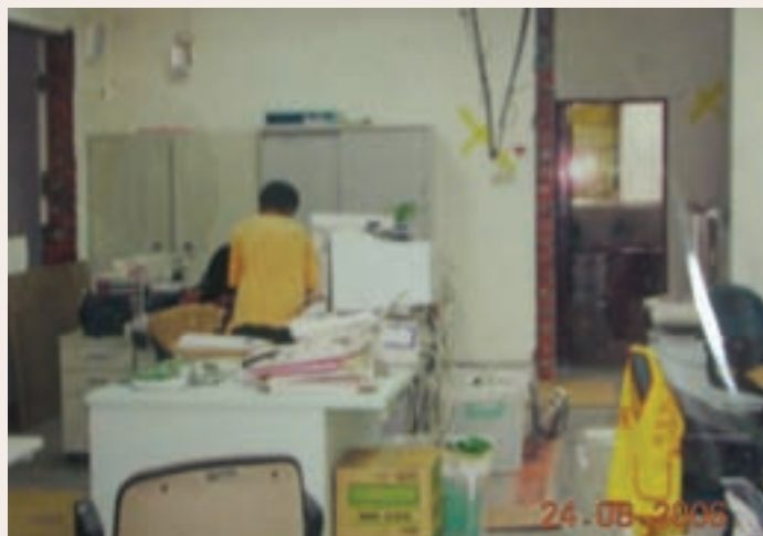
本處新建大樓1樓921地震受損情形
