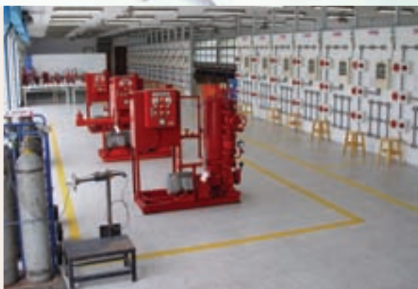
消防安全設備實習場 (94.11)
