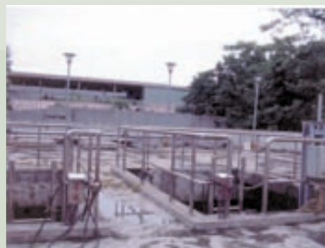
污水處理廠排放分流管線
