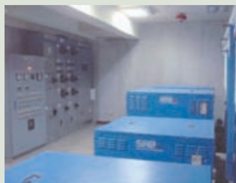
污水處理廠主機房
