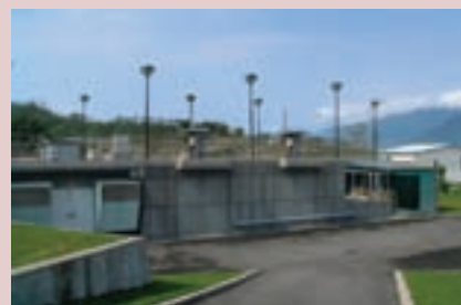
家區衛生下水道及污水處理廠近照
