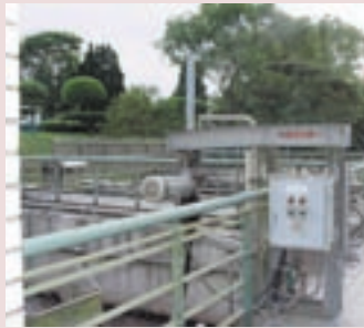
污水處理曝氣池
