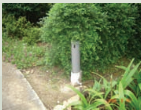
魚池周圍加裝紅外線警示器
