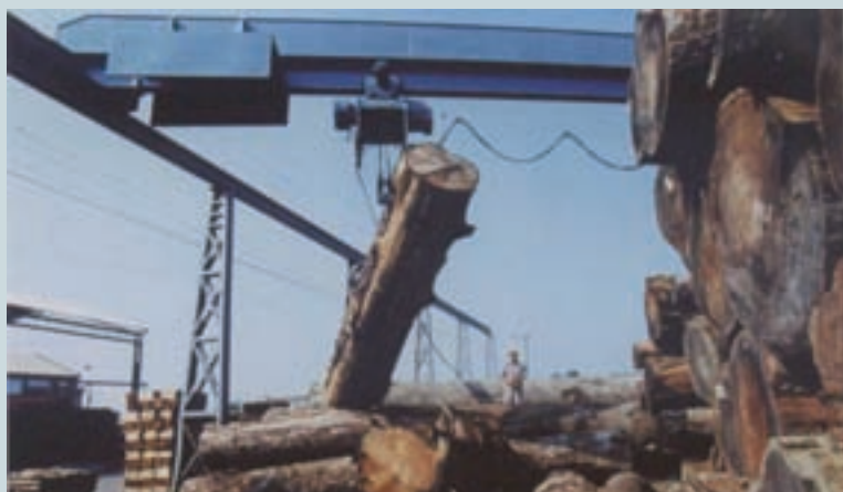
原木製材吊車設備
