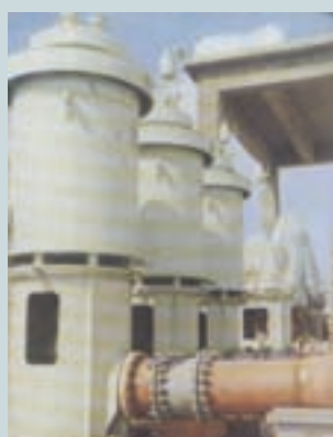
中鋼水處理設備
