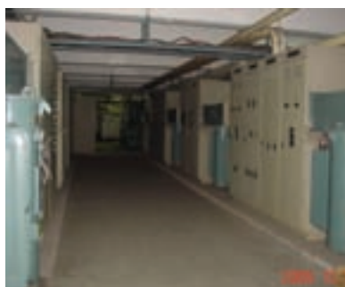
地下室電力設備
