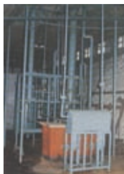
乙炔純化設備
