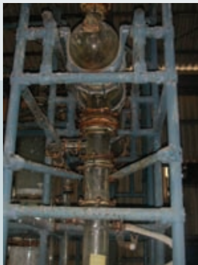
酸場生產線冷凝器
