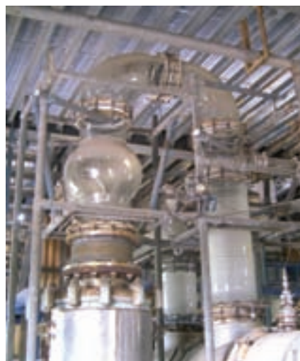
硝酸提濃設備
