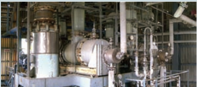
酸場生產線製酸設備
