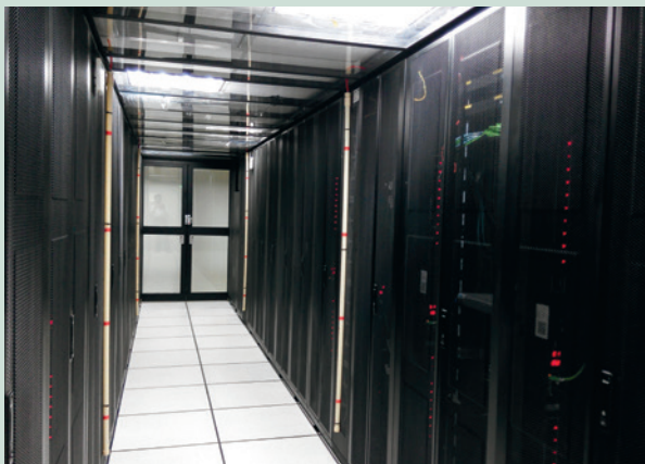
改建後電腦機房—冷熱通道分離、結合環控系統之節能減碳綠能機房。
