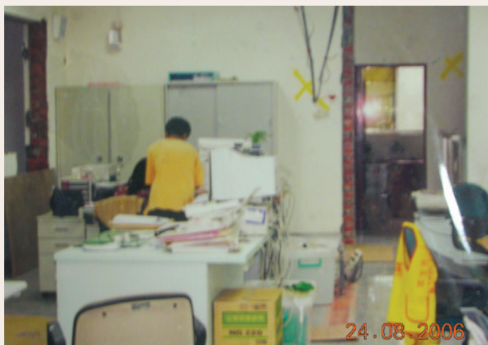
本處新建大樓1樓921地震受損情形。
