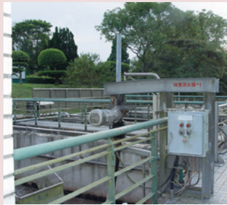
污水處理曝氣池。
