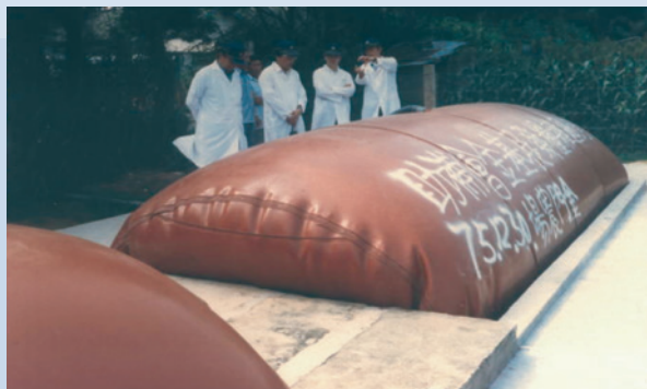
民國74年推動環保及沼氣回收再利用設備。
