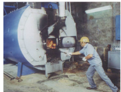
廢木料為燃料之蒸汽鍋爐提供木材乾燥熱源。
