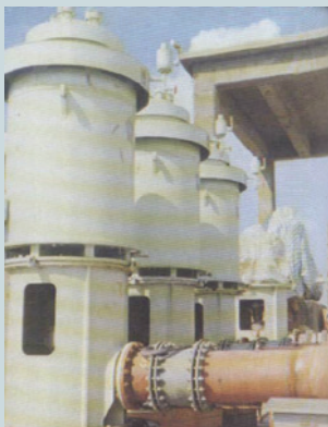
中鋼水處理設備。
