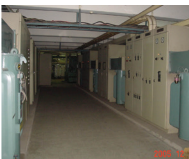
地下室電力設備。
