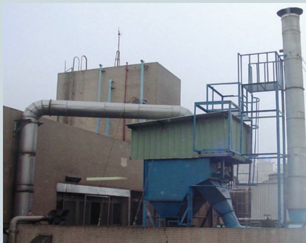
粉塵處理設備。
