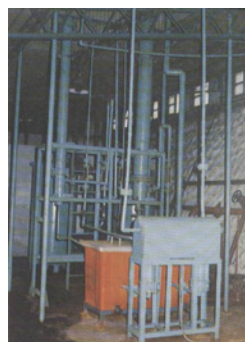
乙炔純化設備。
