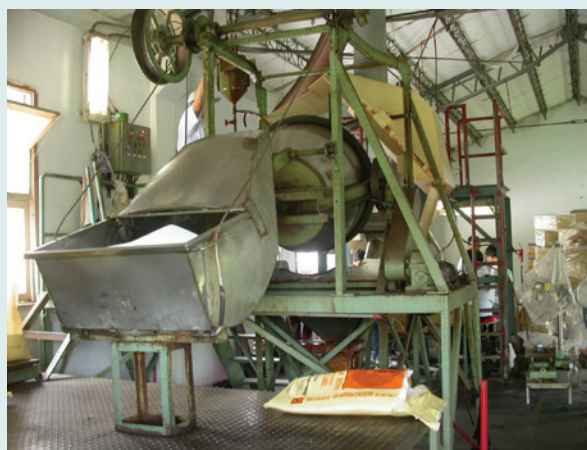
硝油炸藥生產設備。
