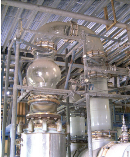
硝酸提濃設備。
