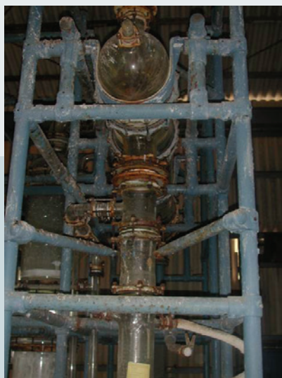
酸場生產線冷凝器。
