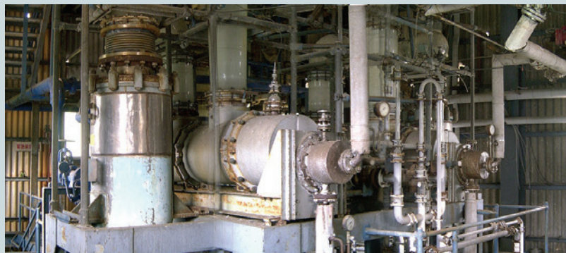
酸場生產線製酸設備。
