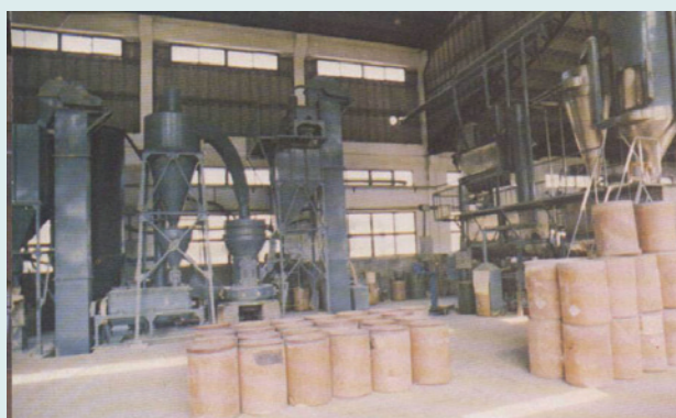
粉劑工場磨粉設備。
