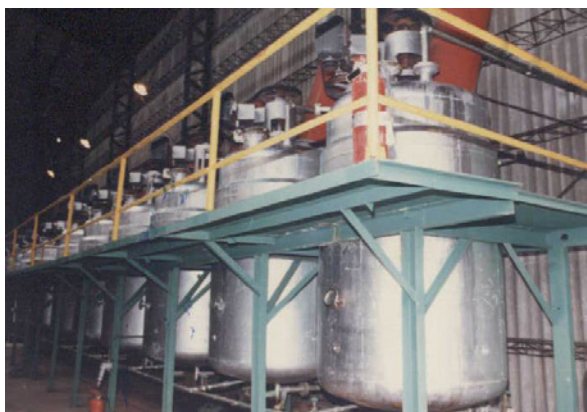
巴拉刈農藥生產設備。
