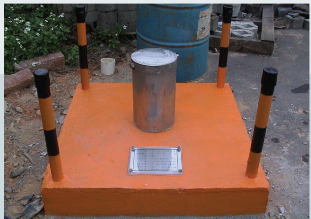
地下水監測井。
