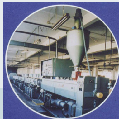
生產PE管之機器。
