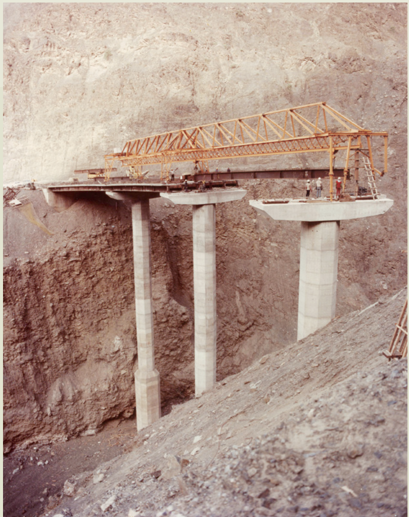
沙烏地夏爾降坡道路工程吊裝鋼樑，施工人員在懸崖山谷間作業，極其驚險。
