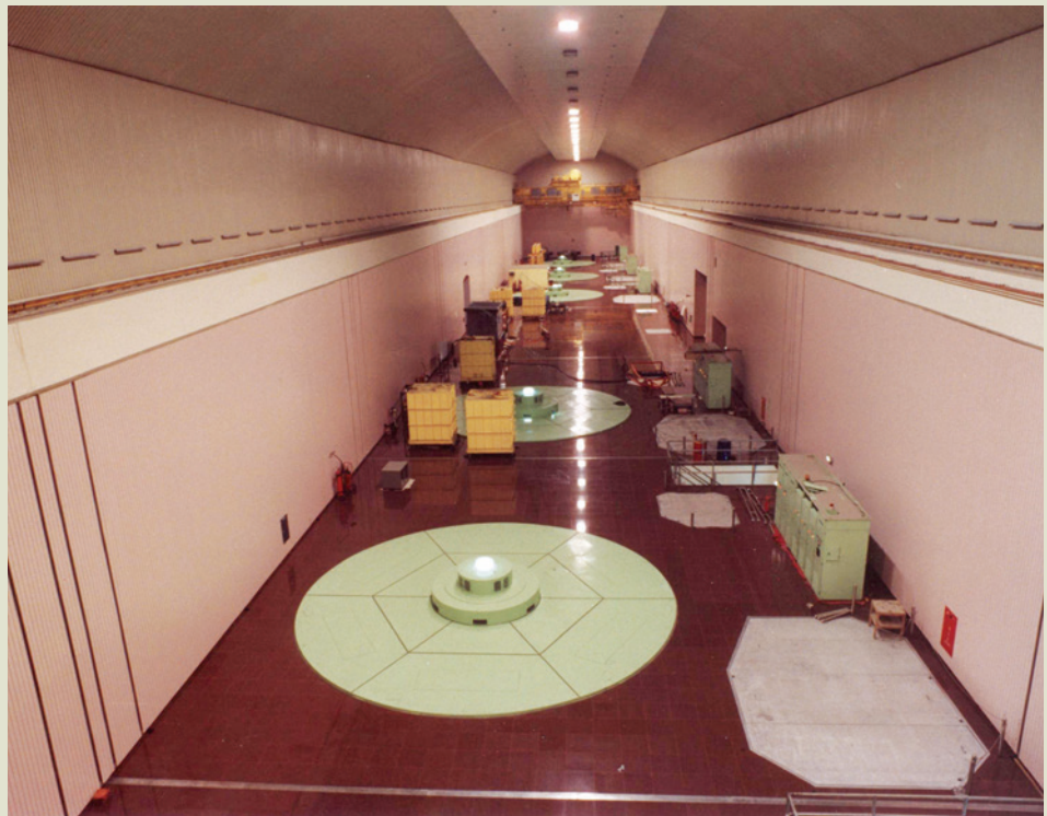
台電明潭抽蓄水力發電廠地下廠房。
