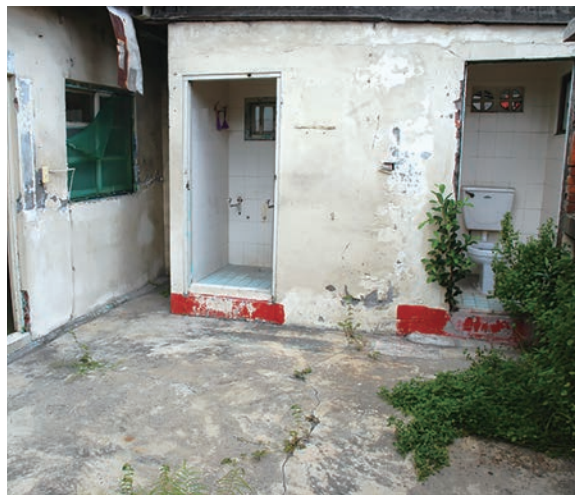
▲東三巷 97-1 號整修前的剪影，斑駁的牆面刻滿了歲月的痕跡。(圖／高雄市政府文化局)
