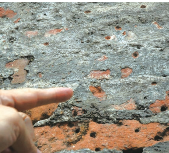
▲高塔外牆仍清晰可見早年機槍掃射的彈孔。
