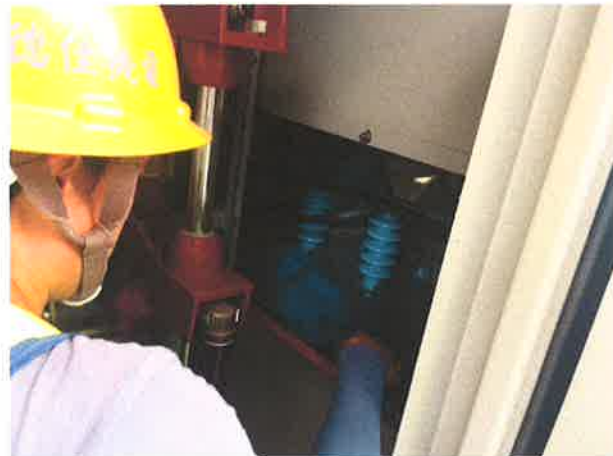
說明：高壓盤內清潔維護，記錄照片。
