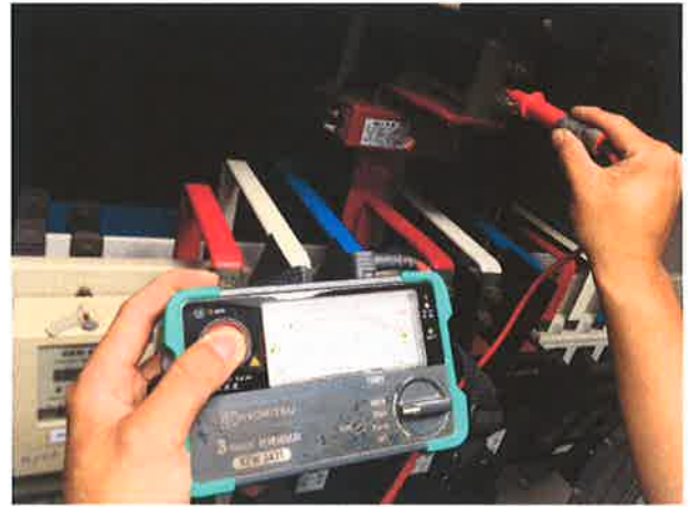
說明：各分路開關量測絕緣電阻，記錄照片。
