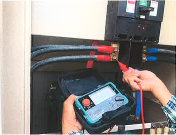
說明：各分路開關量測絕緣電阻，記錄照片。
