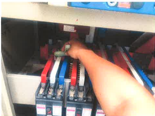
說明：低壓盤內清潔維護，記錄照片。
