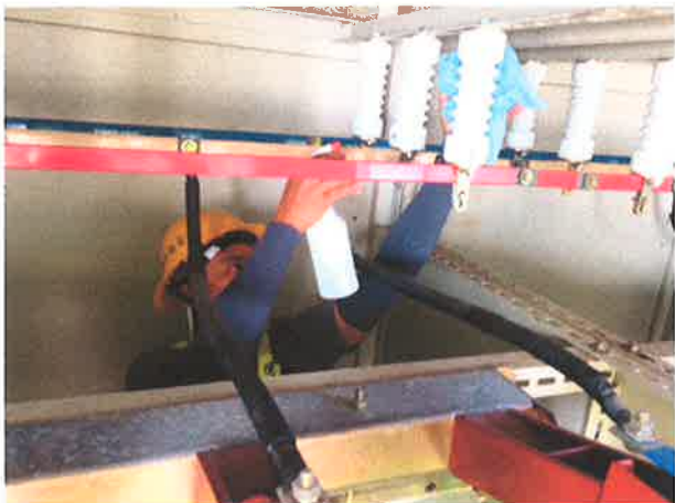
說明：高壓盤內清潔維護，記錄照片。
