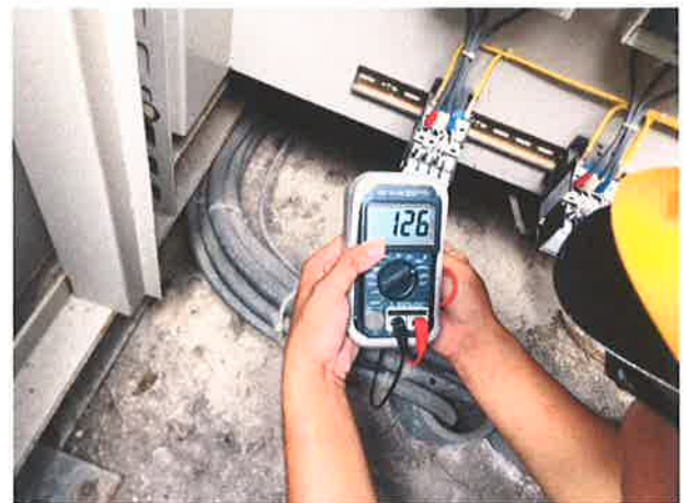
說明：低壓電容器電容值量測，記錄照片。
