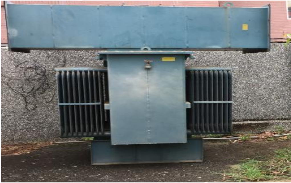
故障高壓電變壓系統內變壓器
