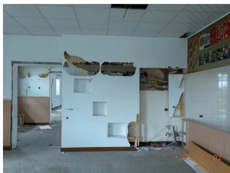
委託經營的廠商以拆除內裝為由破壞原建物，使得衛生設施無一可用。
