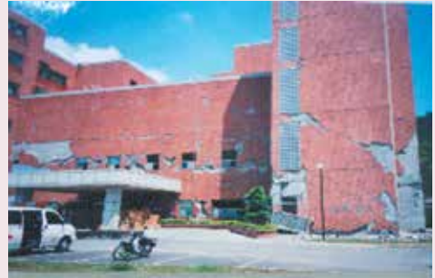
921大地震醫療大樓外觀損毀情形。
