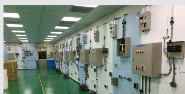
B103室內配線實驗室
