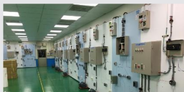
B103室內配線實驗室
