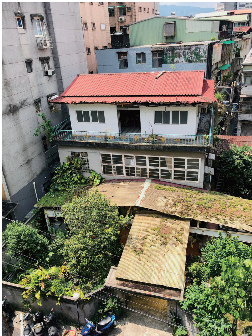
精舍整建前，屋頂剝損，院落搭棚，缺乏魅力。（圖／甘珠精舍）
